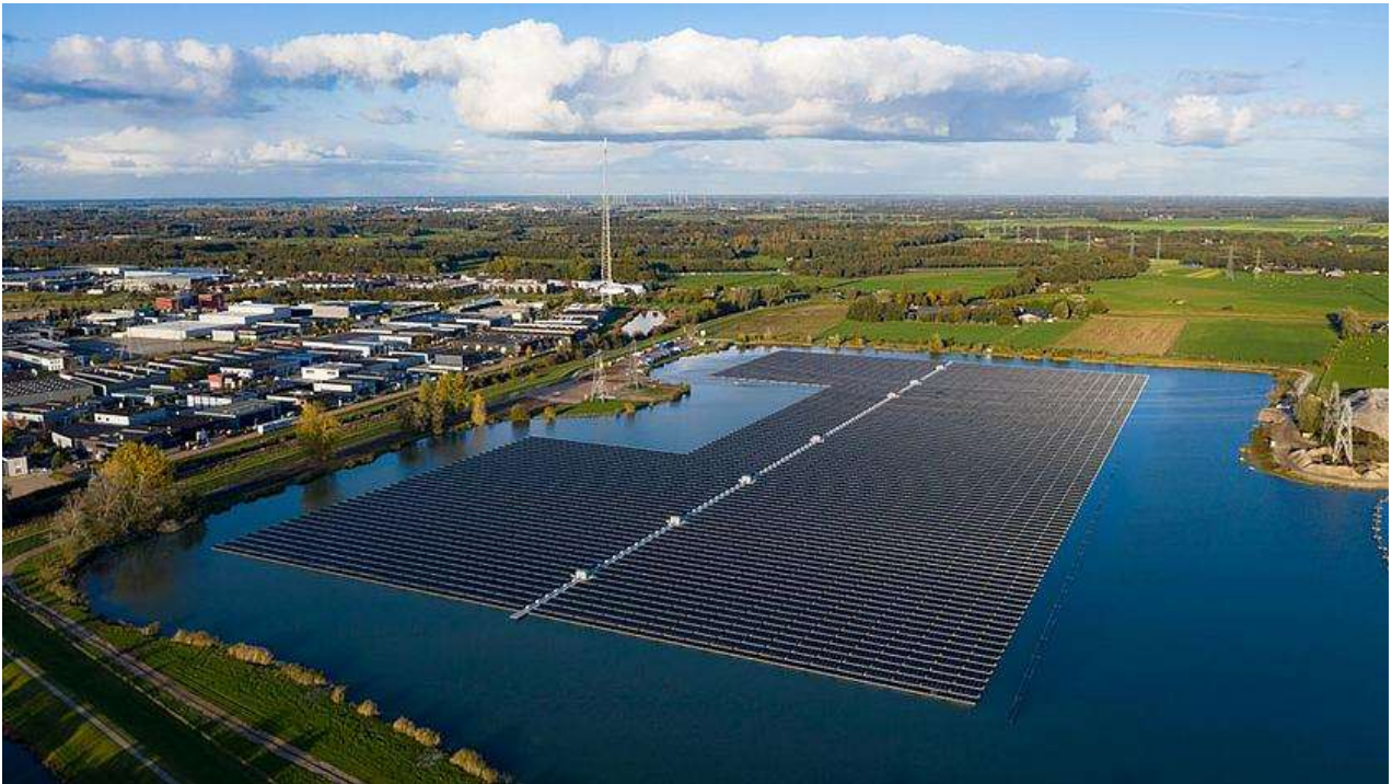
Abbildung 26: Floating-PV-Anlage auf einem Baggersee / Bildnachweis: BayWa re.
